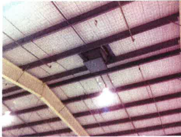
Fig. 4 – Existing Arena Exhaust Fan
