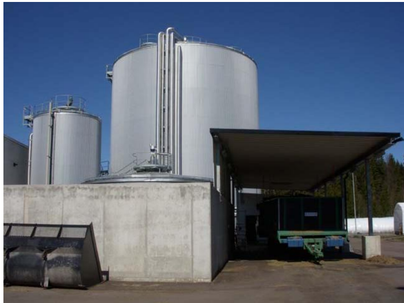
Figure 14 Västerås Svensk Växtkraft Digester with the Ley Silage Feeding Facility
